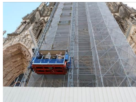
Ascenseur permettant l'accès au chantier, situé à plus de 35 mètres de haut
